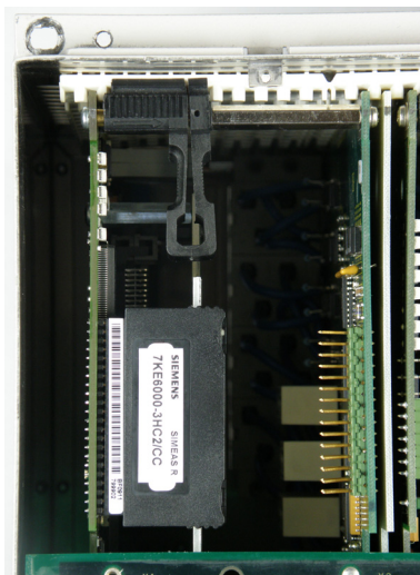
Bild 3-16 DOM-Flash-Speicher auf der CPU-Baugruppe
